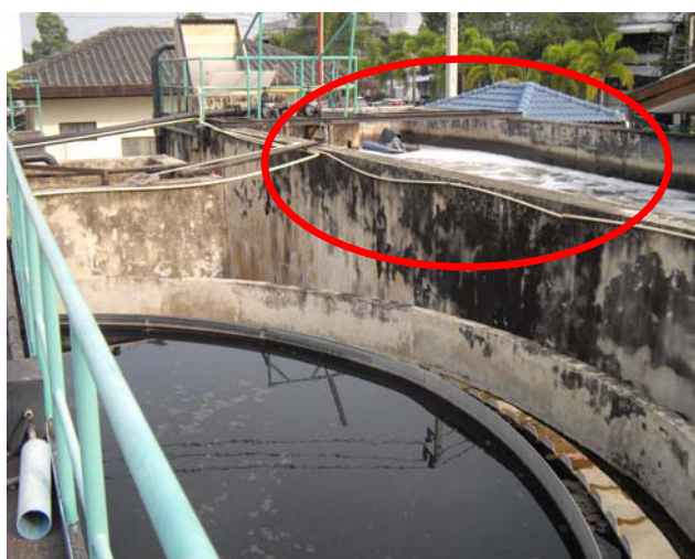
ภาพที่ 10. บ่อปรับสภาพระบบบำบัดน้ำเสียคลองวนเวียน
